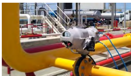
Terminal de almacenamiento de hidrocarburos
