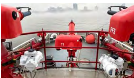
Control de flujo de agua en barco de bomberos
