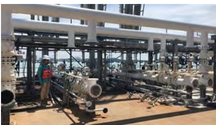
Control de flujo en terminal de químicos y petrolíferos
